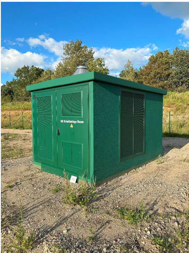
Abbildung 18: Beispiel einer Trafo-Station (Foto: EE-Plan)
