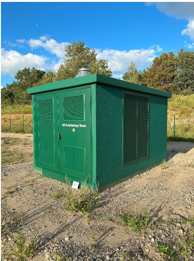
Abbildung 18: Beispiel einer Trafo-Station (Foto: EE-Plan)
